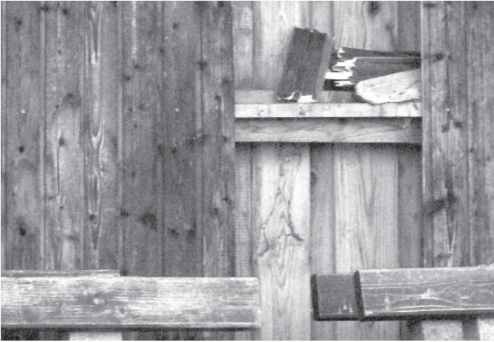
Die Holztribüne wird systematisch abgerissen: Die Vorstandschaft des Sportvereins Albaching ist entsetzt!
