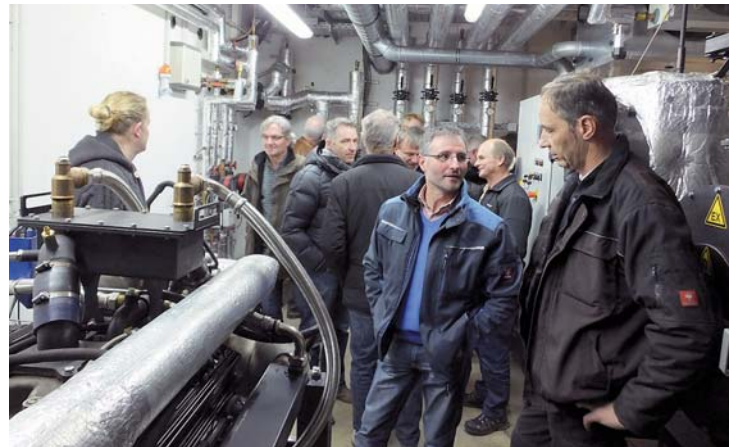
Die Holzvergaseranlage von Höpfl Sebastian (rechts) in Babensham hat sich bewährt. Er will demnächst eine zweite Anlage errichten. Die Nachfrage nach Fernwärme steigt.
