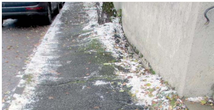
Die Gefahrenstelle mit den erheblichen Unebenheiten des Asphaltbelags des Bürgersteigs am Doktorberg.
