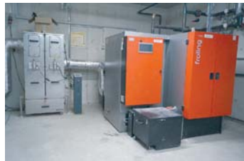
Die Anlage im Keller verrichtet problemlos ihren Dienst.
